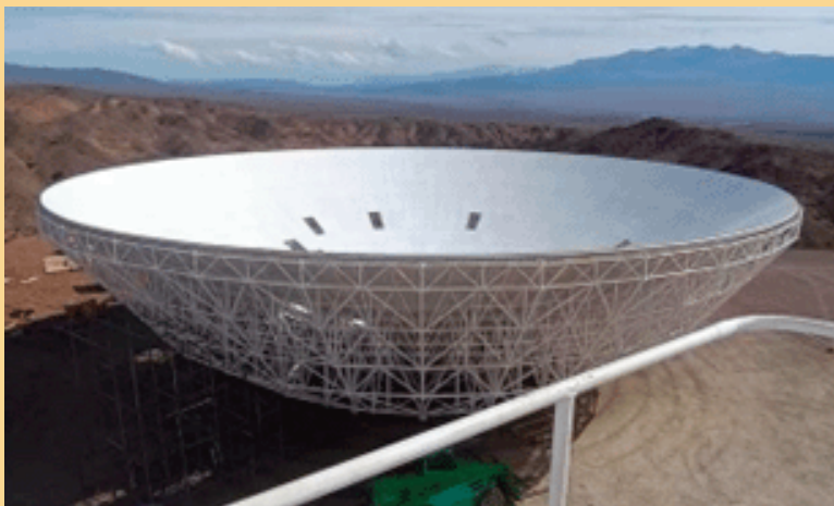
En la foto se puede ver el avance en el montaje del plato del radiotelescopio.
