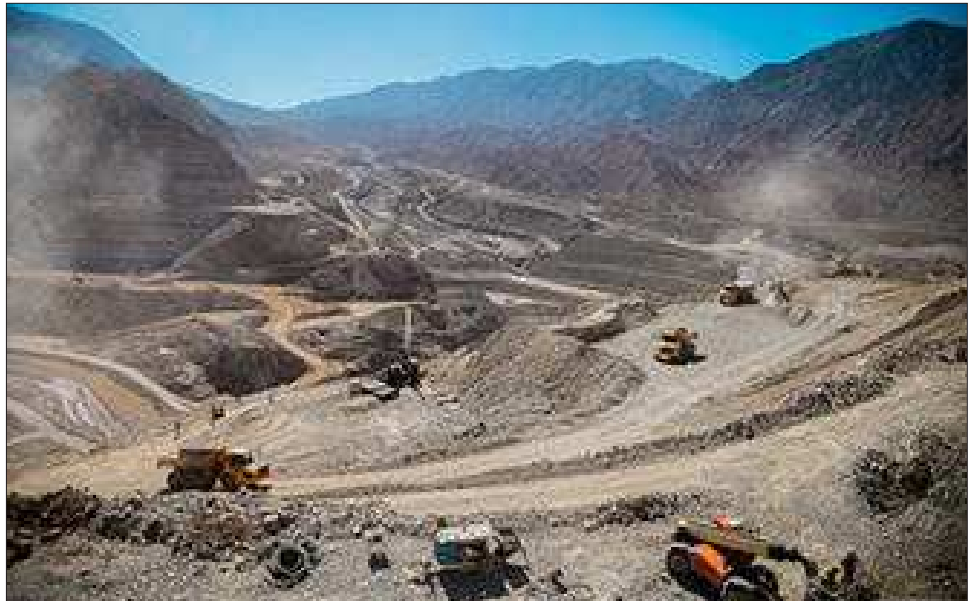
El dique venía con obras demoradas
