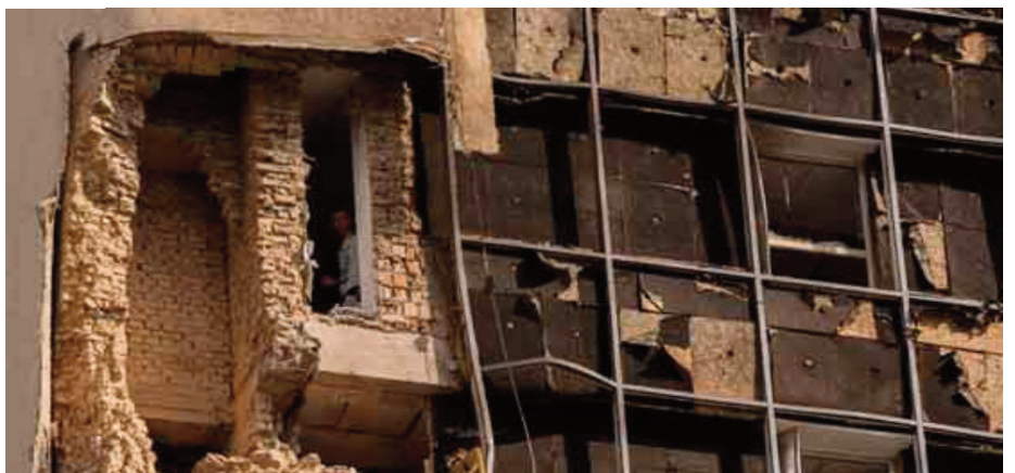
Así quedó el edificio atacado en Izmail, Odesa, tras el bombardeo ruso
