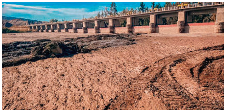
Actualmente se presenta un embanque de aproximadamente unos 8.000 m 3 de material sedimentado en la zona de carga del dique
