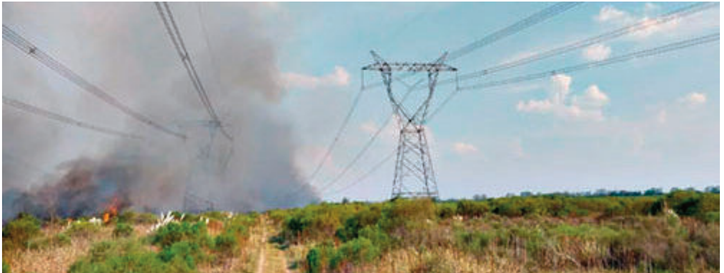
Un incendio de pastizales afectó la línea de 500Kv que une Campana y Rodríguez
