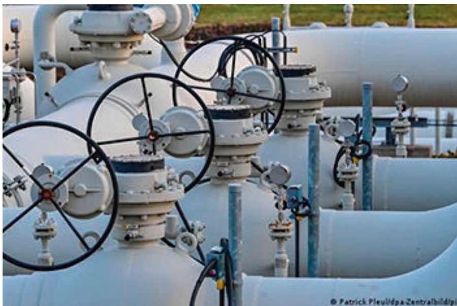
Estación compresora de gas natural en Alemania, una de las que recibe gas ruso que transita, en parte, por Ucrania.
