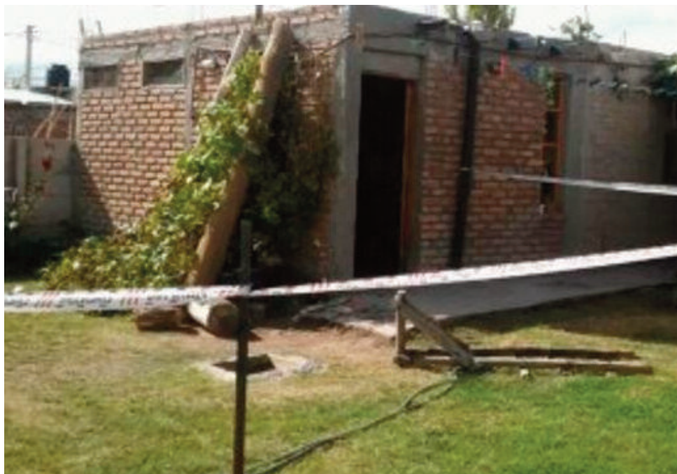
La vivienda donde se produjo la descarga
